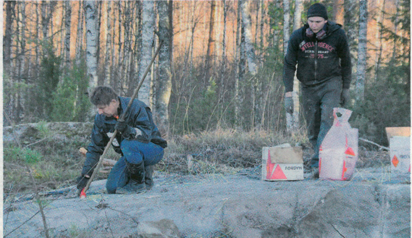
Veijo Seppänen ja Jari Nauha räjäyttivät tiistaina kenttätömaalta kalliota noin 37 neliön alueelta.
